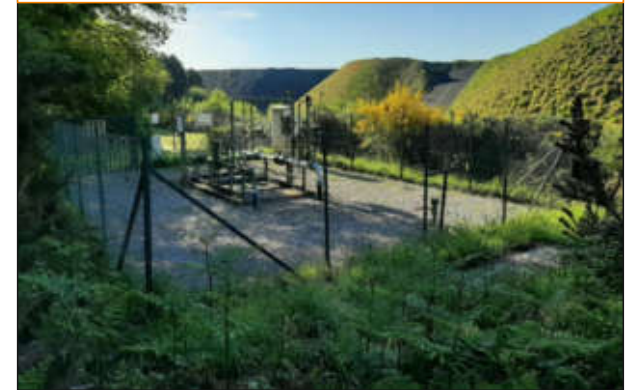
Poste de livraison GRT Gaz - IRMG (2)
