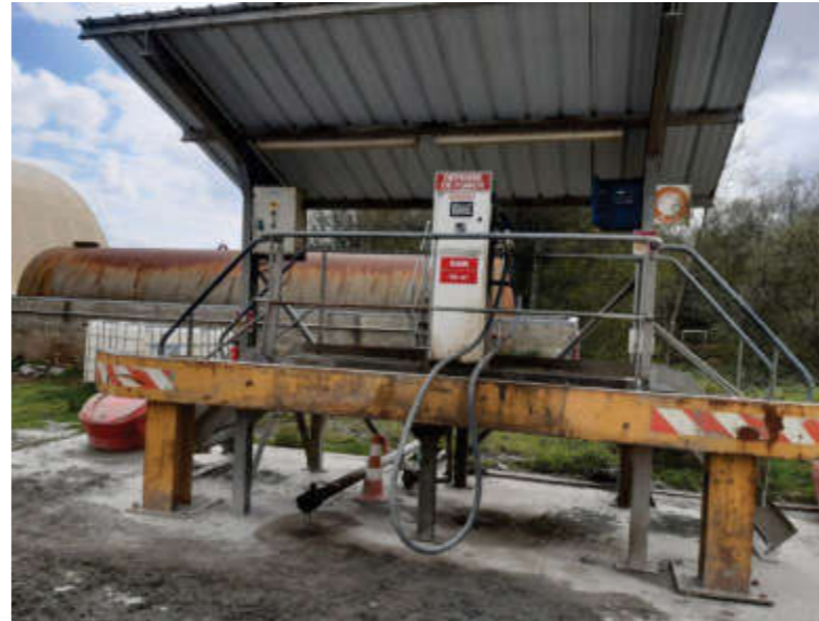
Cuve GNR carrière: 50 m 3 (engins sur roues)
