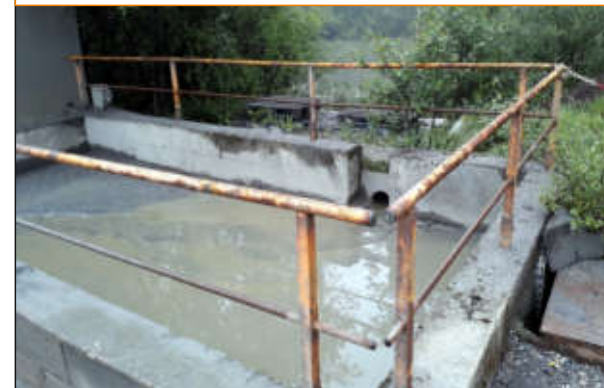
Débourbeur déshuileur (Bassin Richier)
