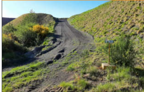
Conduite de gaz enterrée et balisée après le poste de livraison (1)
