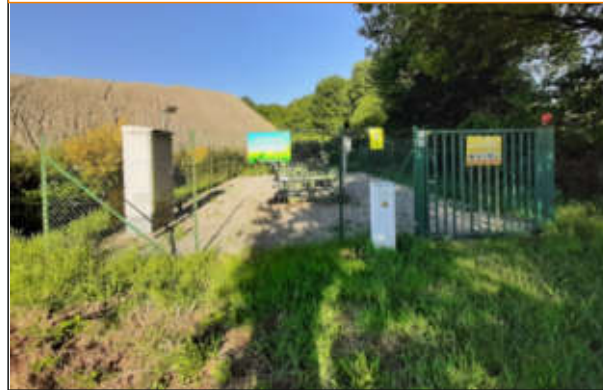
Poste de livraison GRT Gaz - IRMG (1)
